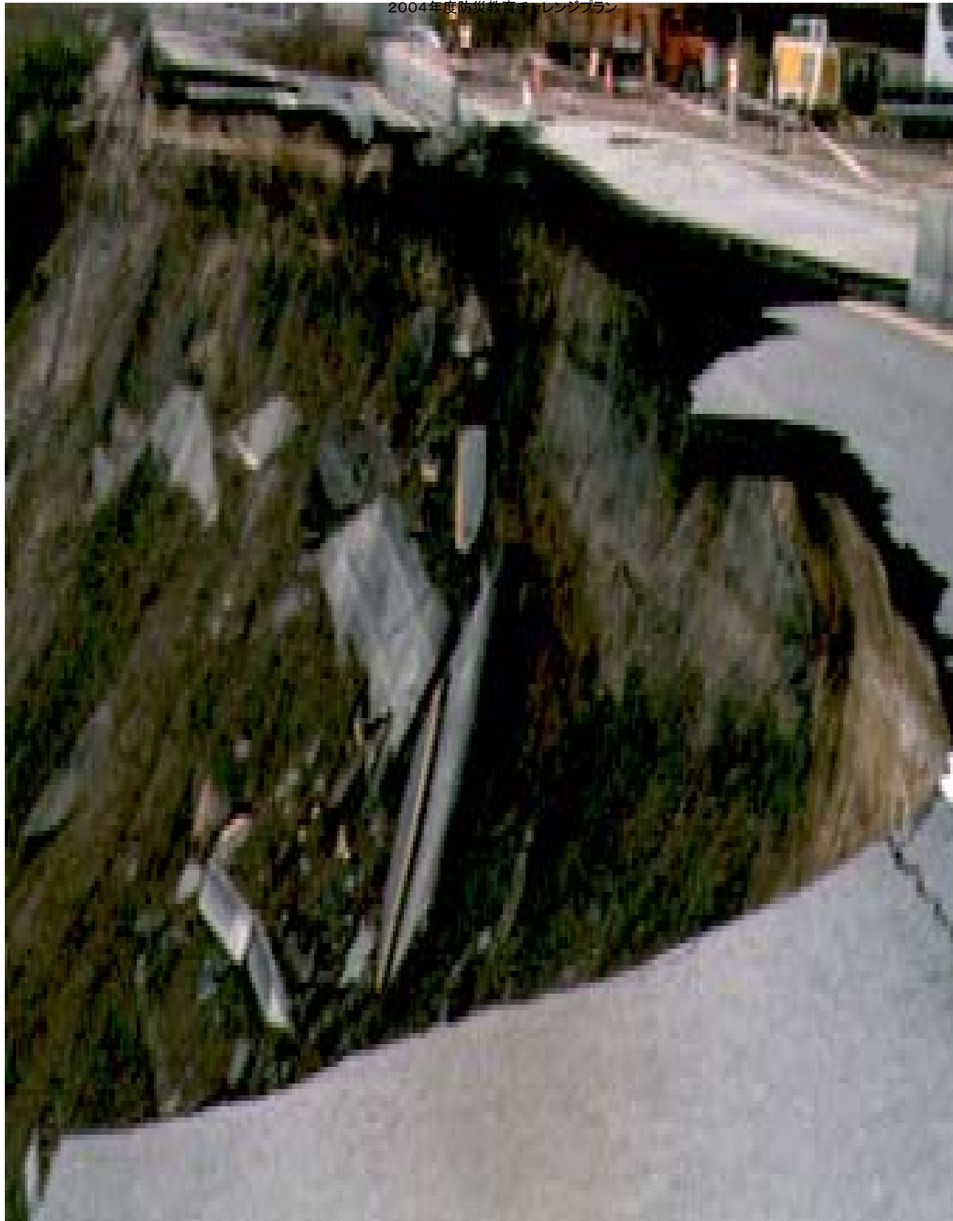
ボルからカイナシュリへの幹線道路の崩壊(1999年11月)
