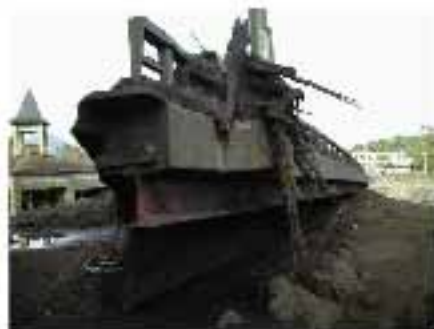
泥流に流された橋
