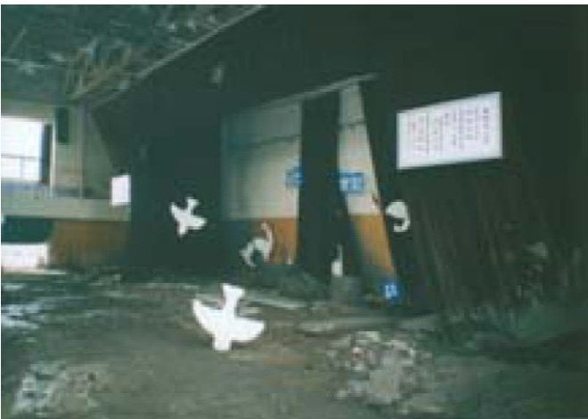
泥流に埋まる体育館 2
