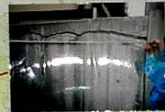
②家の土台に亀裂が入っていて危険です。
