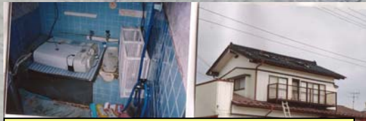
平成15年の地震による被害
