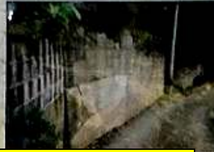
・ブロック塀 地震でひび割れ。
