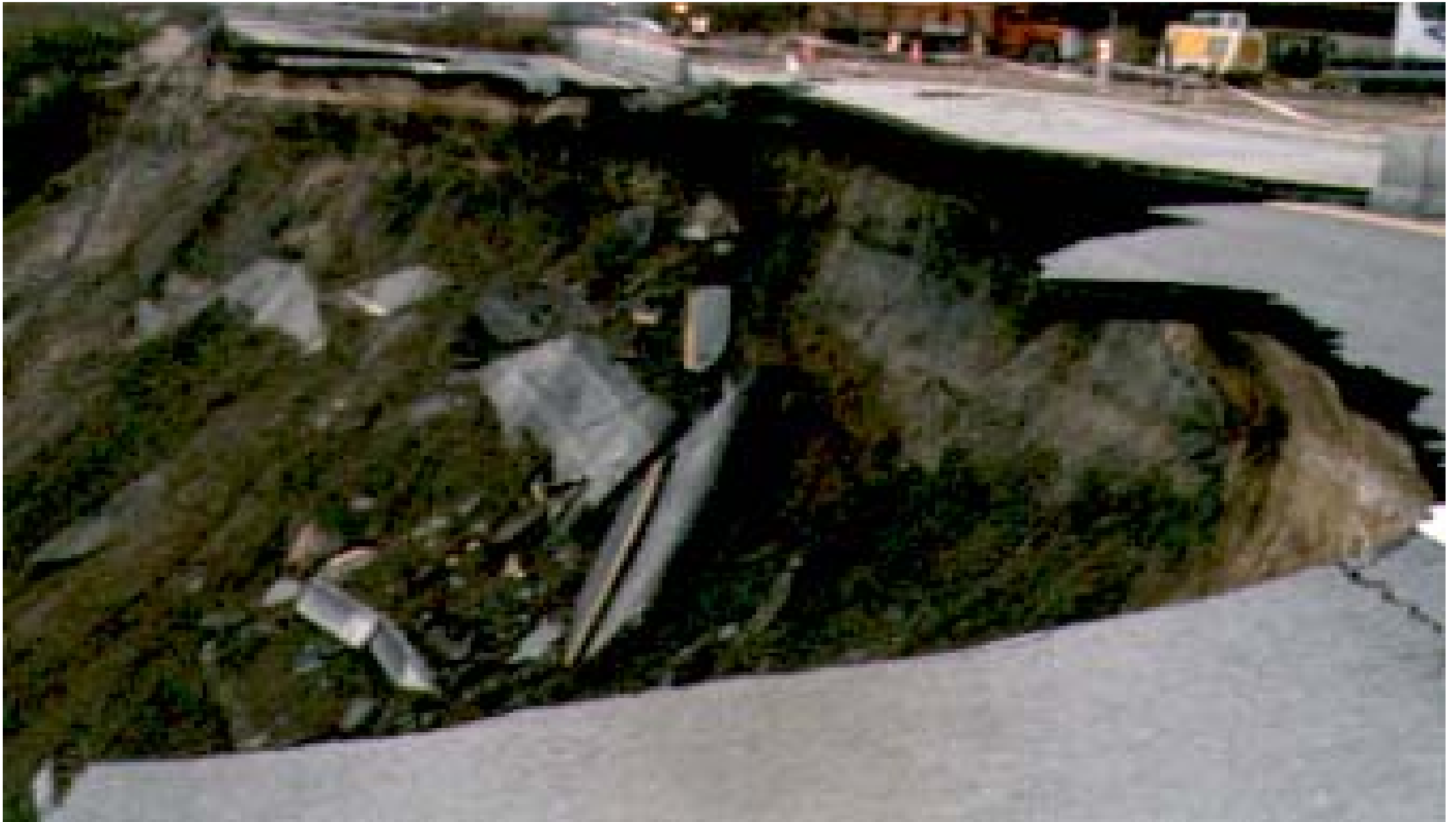
ボルからカイナシュリへの幹線道路の崩壊(1999年11月)
